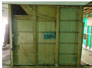
↓筋かいが不足し、建物の強度が弱い。
