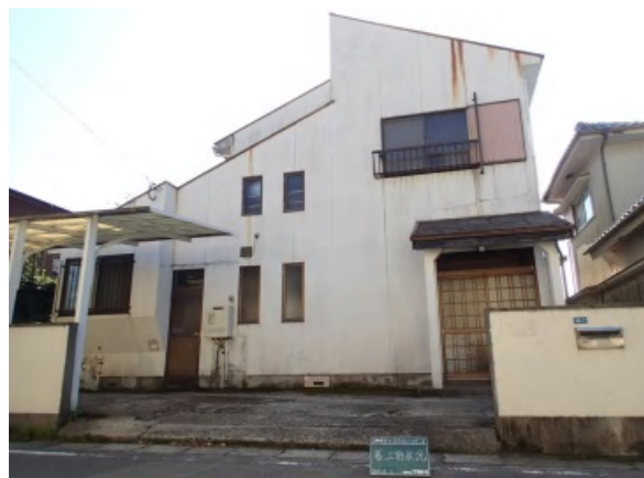
←外周全体にふくれやクラック等の老朽、劣化がみられた。
