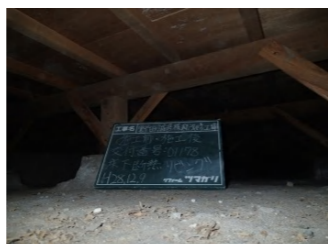
↓床下への断熱がなされず。
